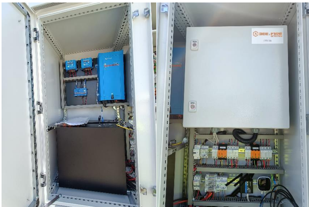
Foto do Quadro Principal (instalado a 2.5 m de altura), componentes do sistema PV (foto à esquerda) e quadro de controlo dos equipamentos periféricos do sistema Bee2Fire (foto à direita)
