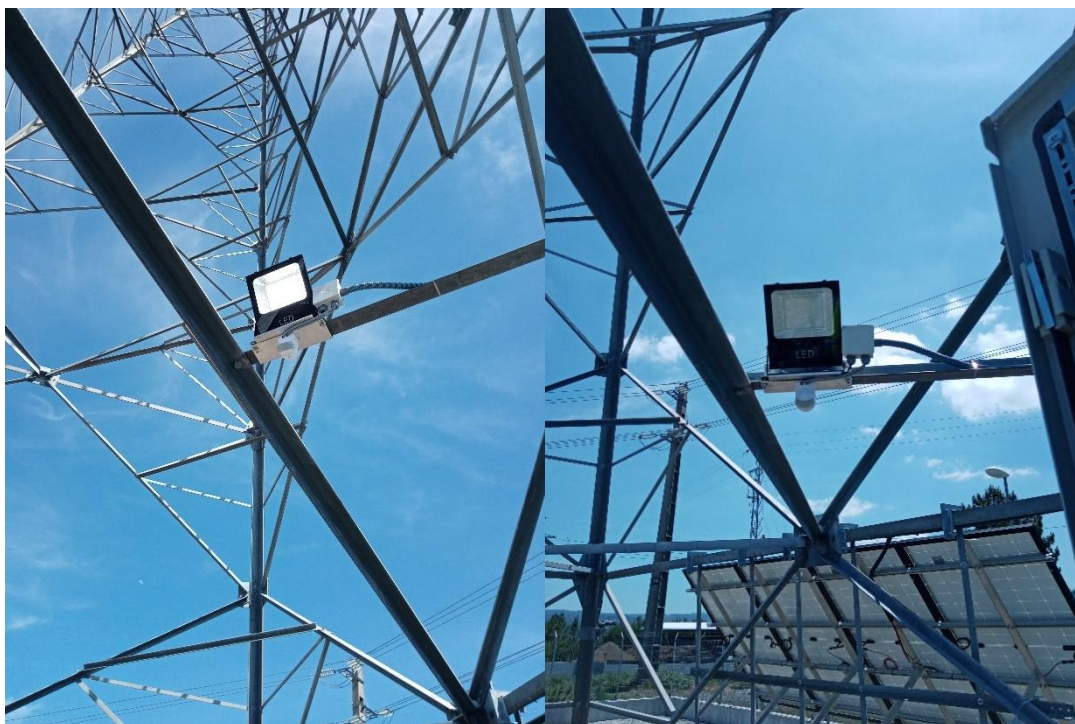
Foto do quadro do sistema de Intrusão instalado na Torre SRR (Projektor LED e Sensor PIR)
