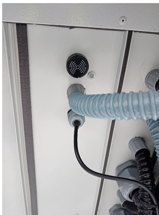
Foto do quadro do sensor sonoro instalado na parte inferior do Quadro Principal
