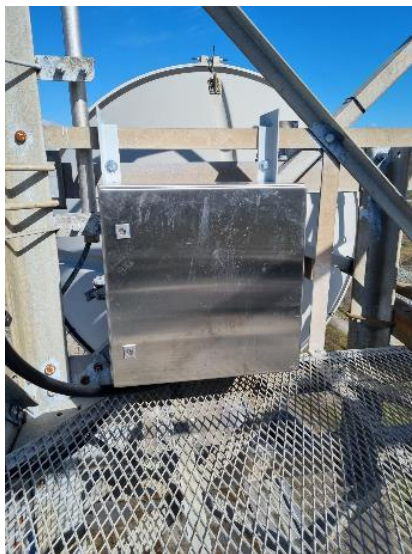
Foto do Quadro Secundário e Suporte (instalado no topo da torre – Quadro Inox 500x500x300)
