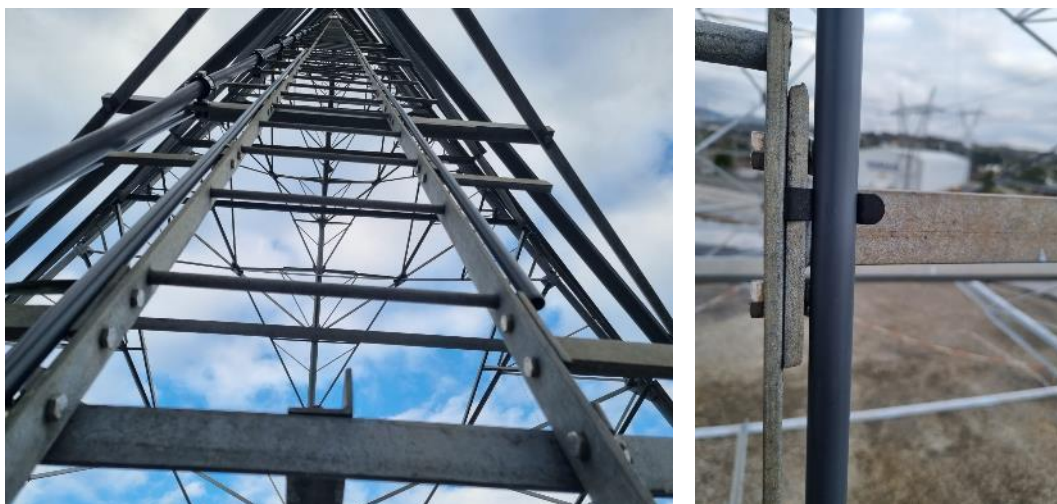
Fotos da tubagem PVC para passagem de cabo de alimentação e comunicação (instalada ao longo da escada de acesso ao topo da torre) e do clip de fixação da tubagem
