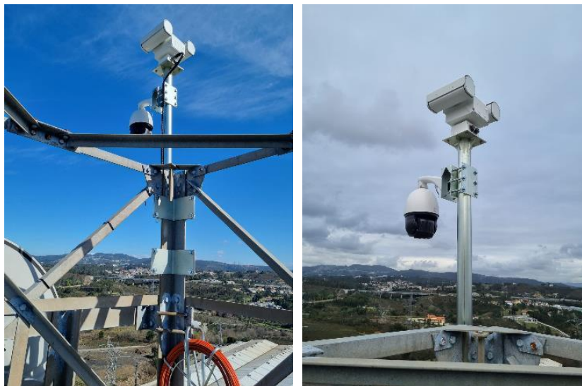
Foto das fixações do Suporte à Cantoneira Montante da Torre (esquerda) e Foto das Câmaras Instaladas no Suporte (direita)
