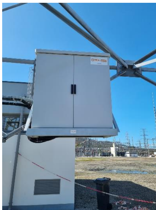
Foto do Quadro Principal no Suporte de fixação
